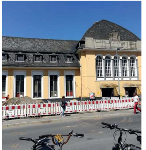
Trotz vieler Versprechen der Deutschen Bahn lässt die Sanierung des Höchstler Bahnhofsgebäudes auf sich warten. Foto: A. Schlosser
